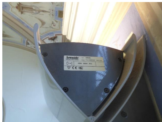
Figura 4.12 - Particolare dei corpi illuminanti
